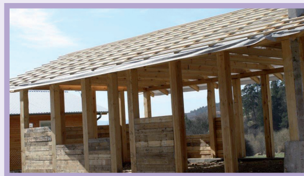
Výstavba drevodomu s využitím „odpadového“ dreva Construction of a wooden house using „waste“ wood.
