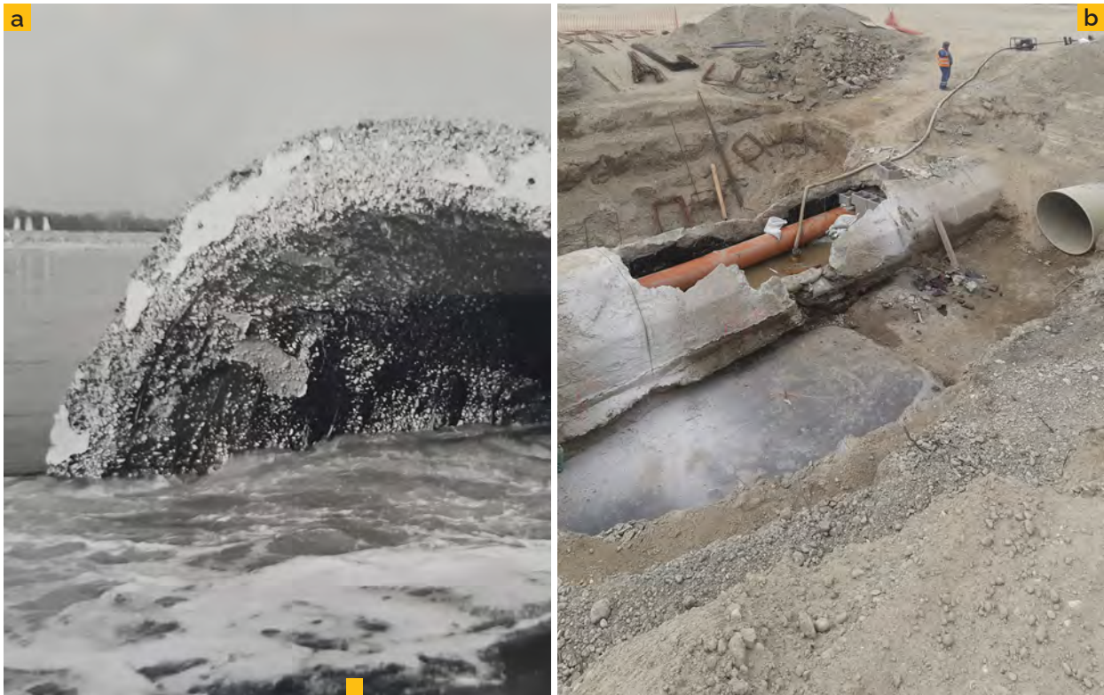
2 a) Pôvodný výustný objekt I. kanála CHOZ v roku 1975 b) Odkryté teleso kanála počas prekládky v súvislosti so stavebnými prácami na diaľničnom úseku R7 Prievoz-Ketelec (október 2019)
