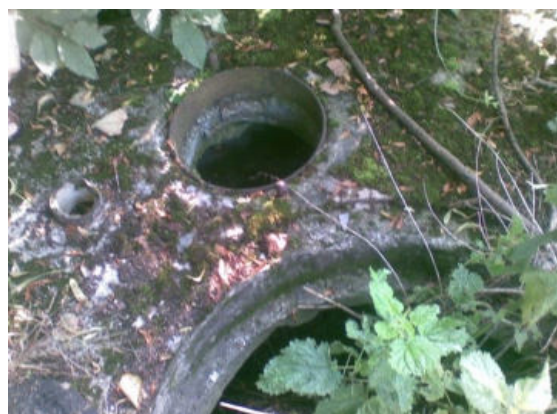
Obr. 4: Šachta k podzemnej nádrži
